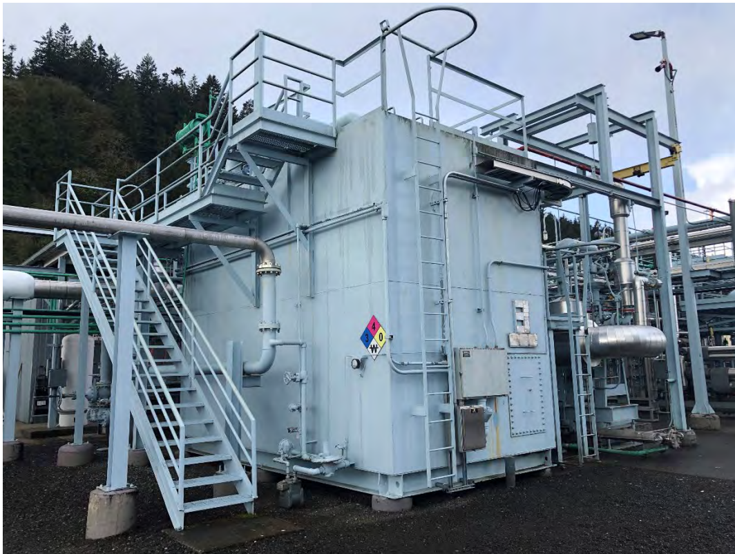
Figure 6.24: Portland LNG Cold Box
