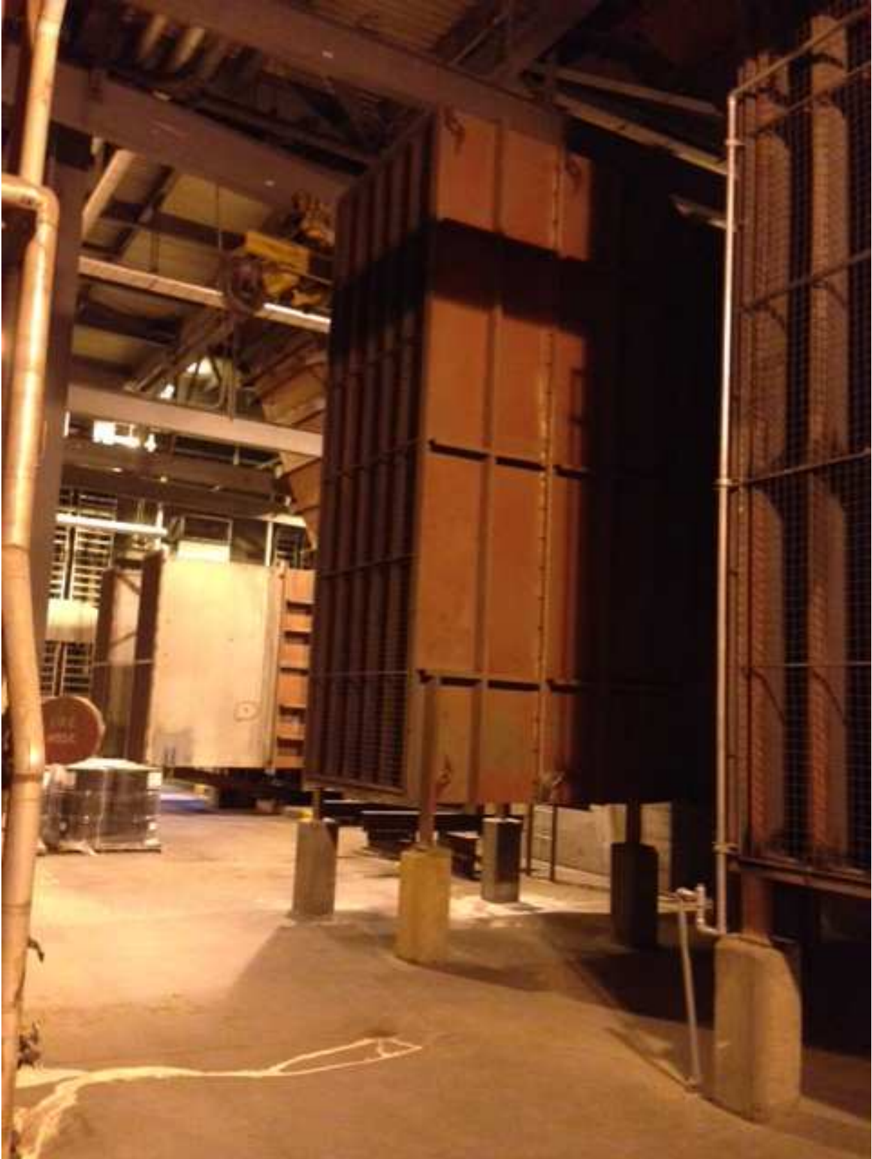
FD Fan inlets
