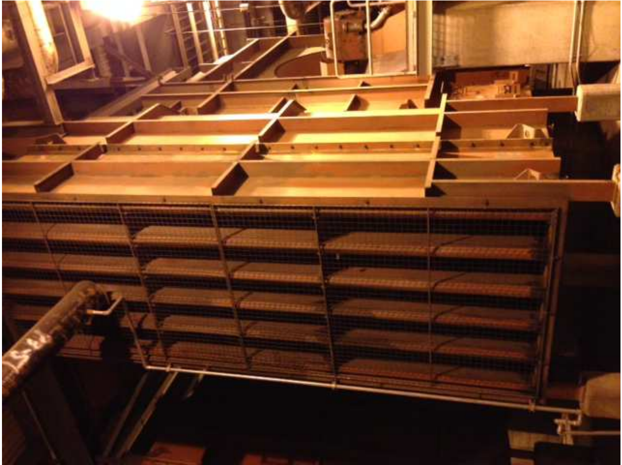
PA Fan inlets
