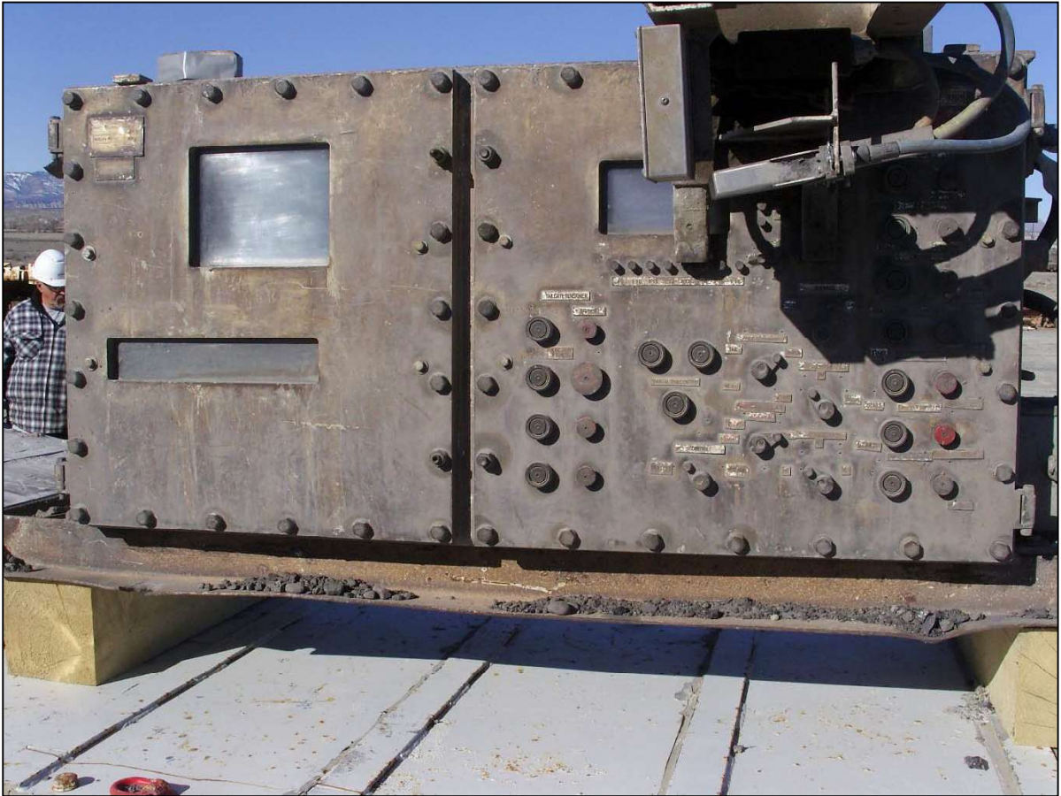
Mini Control Station, 22-999
